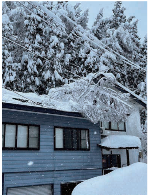
【山形県】舟形町 (倒木により民家の屋根が破損)
