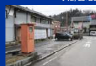
停止した消雪パイプ
