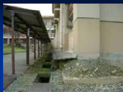
抜け上がった建物基礎
